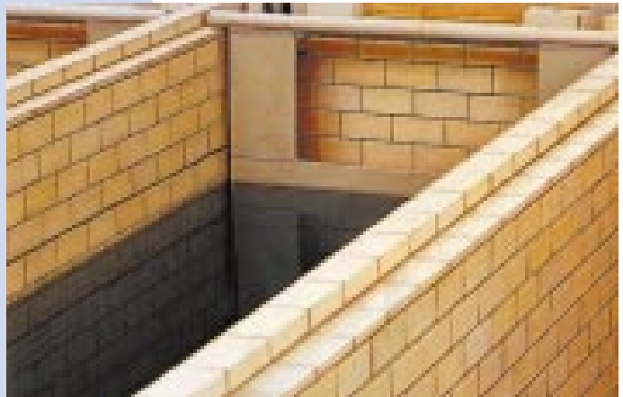
Obložení předúpravové nádrže v závodě na pozinkování ponořením Lining of a pretreatment basin in galvanising plant
